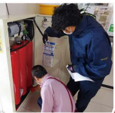
パッケージ型消火設備もしっかりとチェック
